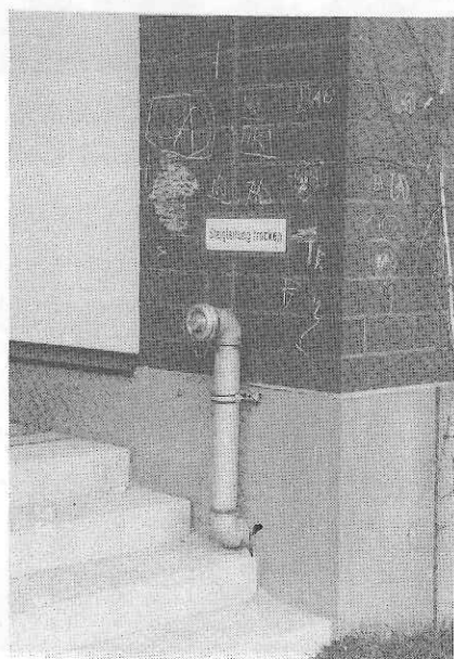
住棟入口の連結送水口
