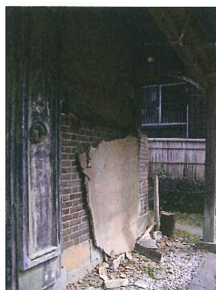
剥落した漆喰仕上げ壁漆 (2011.3.11東日本大地震以降)
