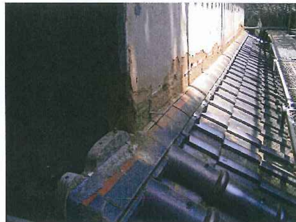
前回補修時に水切りが設けられなかったため 底下に雨が漏水している
