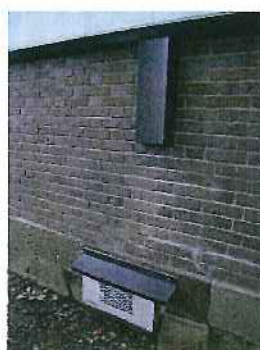
西面の床下換気扇
