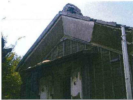
妻側破風部分の漆喰仕上げが3/4剥落し、 下地が見える。
