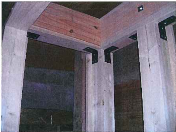
補強柱ほぞ指しできないため金物接合
