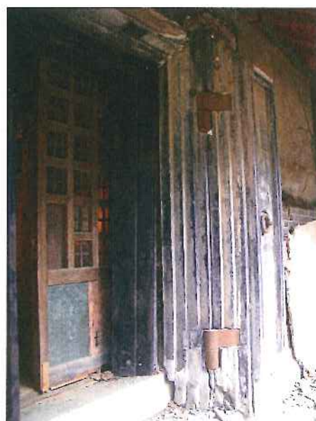
揺れで崩れた漆喰の防火大戸 (2011.3.11東日本大地震以降)
