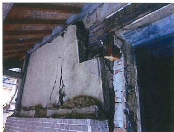
崩落寸前の出入り口脇の漆喰壁
