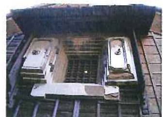
窓底はトタン、野地とも腐朽
