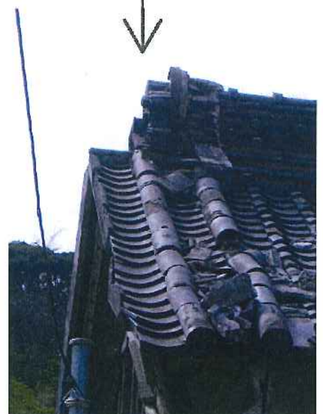
2011.3.11東日本大地震以降、 大きくズレ・破損した鬼瓦、丸瓦
