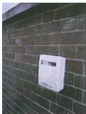
床下換気扇の コントロールボックス
