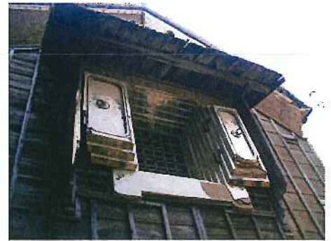
妻側窓庇トタン板は朽ち落ち、 下地野地板もほとんどが腐食している。
